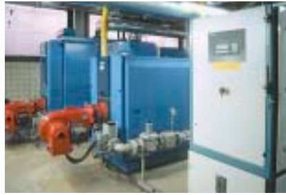
Blick in die Heizzentrale
