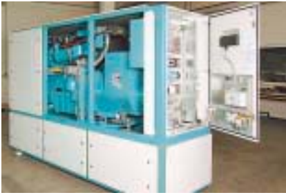
Innenansicht des Blockheizkraftwerks
