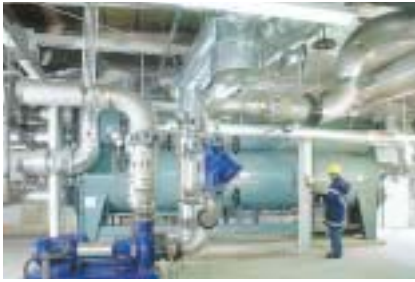
ÄBlick auf die Absorptionskältemaschine
