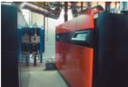
Blick in die Heizzentrale
