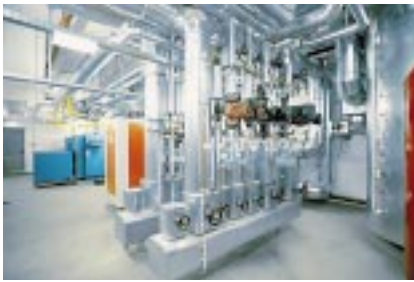
Blick auf die Wärmeerzeugungsanlage
