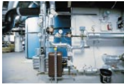
Warmwasserbereitung mit Wärmetauschersystem
