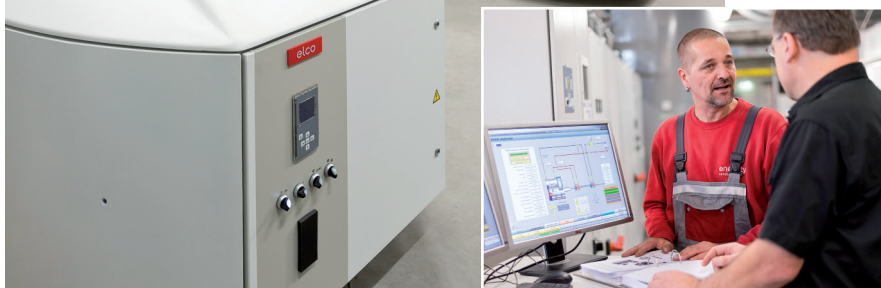
Blick in den Maschinenraum der „Energiezentrale Oberhafen“, die zu einer nachhaltigen Versorgung der „HafenCity“ beitragen wird.
